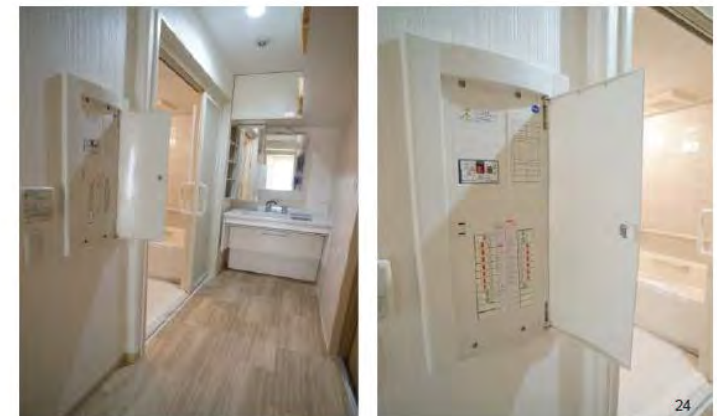
分電盤の扉が開いていて衝突
